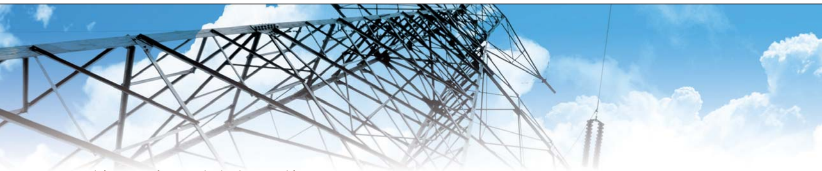
Líneas aéreas de baja tensión
